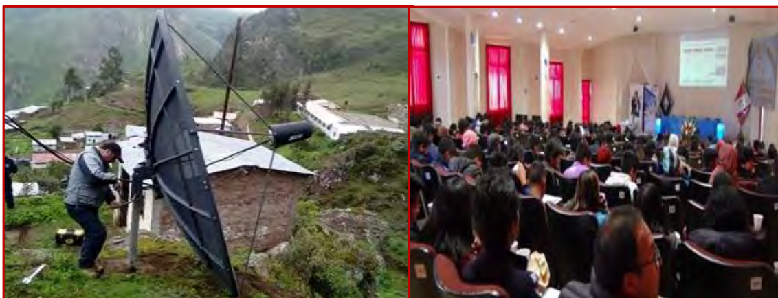
ARMADO DE LA ANTENA PARABÓLICA EN HUAYACUNDO ARMA – CURSO TELECOMUNICACIONES EN LA REGIÓN HUANCVELICA – TICs FORMALIZACIÓN DE RADIO Y TV
