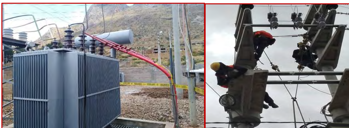
ELECTRIFICACION CHUÑURANRA, CALLQUI Y MILLPO-HVCA – ELECTRIFICACION CCASIR, MOSOCCPAMPA Y LA MERCED EN CHURCAMP
