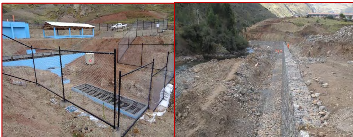
PIPS DE SANEAMIENTO DE HUANCALPI, VILCA Y CALQUI CHICO DE HVCA
